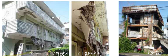
2階の廊下部分が崩落した事例
