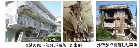
■ 管理不全マンションの例
